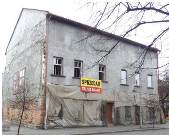
OBECNY, GODNY WSZELKIEGO POTĘPIENIA, WYGLĄD KAMIENICY. POTĘŻNE PRZYPORY OD STRONY PÓŁNOCNEJ ŚWIADCZĄ O SKLEPIENIACH WEWNĄTRZ (FOT. A. FRYŚ)
